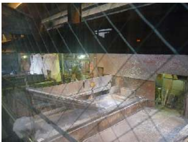
操作室の網入りガラス越しに見ためっき槽
