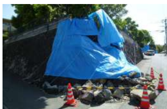
擁壁出隅部の崩壊
