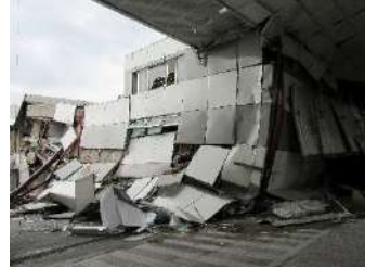
熊本市内の被害状況 (写真はスーパーマーケット)
