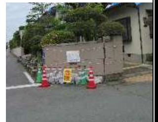
危険なブロック塀
