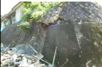
増積み擁壁の崩壊
