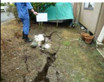
宅地のひび割れ
